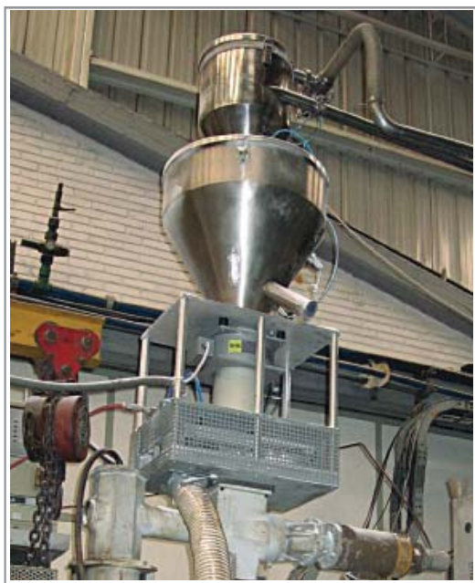
原料供給装置に設置されたPROTECTOR-MF
